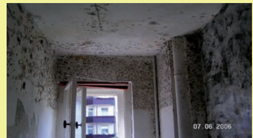
Verschimmelte Wohnung vor der Sanierung
